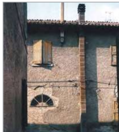
Fig. 6.1 - Каменное здание, подверженное подъему влаги
