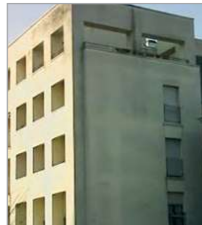
В здании без наружной теплоизоляции мостики холода образуются вдоль балок и колонн. Из-за этого кирпичные стены часто бывают поражены микроорганизмами.
