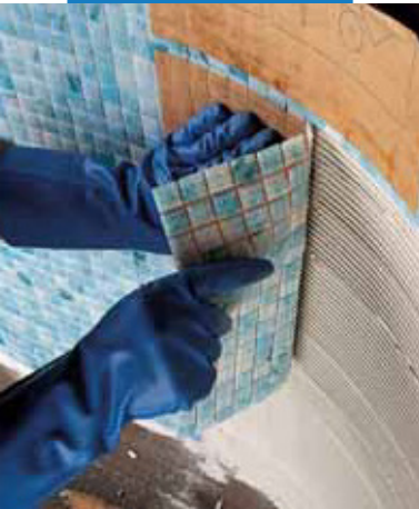
Укладка стеклянной мозаики 2x2 в бассейне с использованием Adesilex P10 (Адесилекс П10) и добавки Admix I, разбавленной водой в соотношении 1:1
