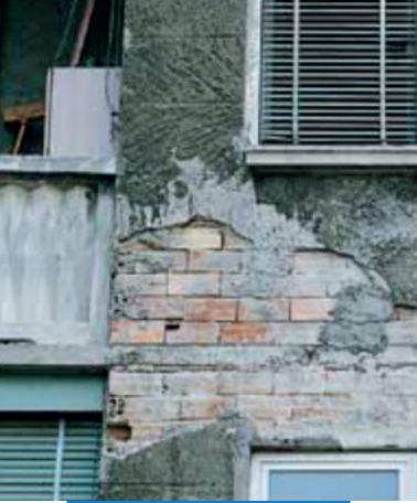
Разрушающийся фасад здания, требующий ремонта
