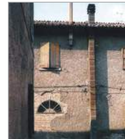
Рис. 6.1 - Каменное здание, подверженное подъему влаги
