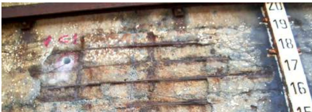
Рис. 10. Коррозия в результате воздействия хлоридов
