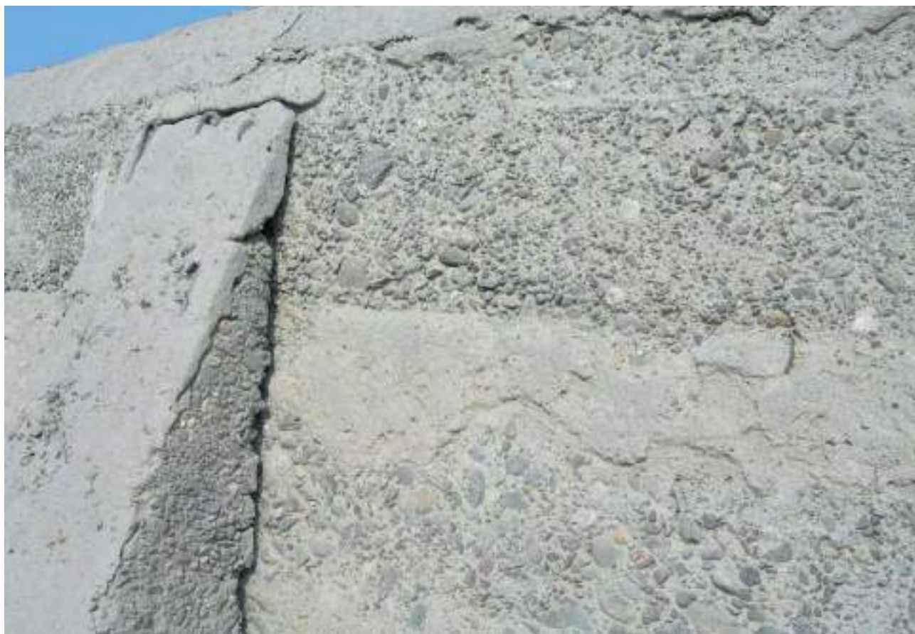
Рис. 6. Влияние выщелачивания на поверхность бетона
