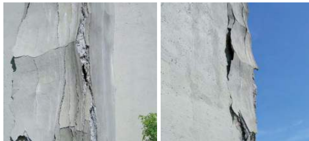
Рис. 7, 8. Пример сооружения, поврежденного в результате агрессивного воздействия сульфатов
