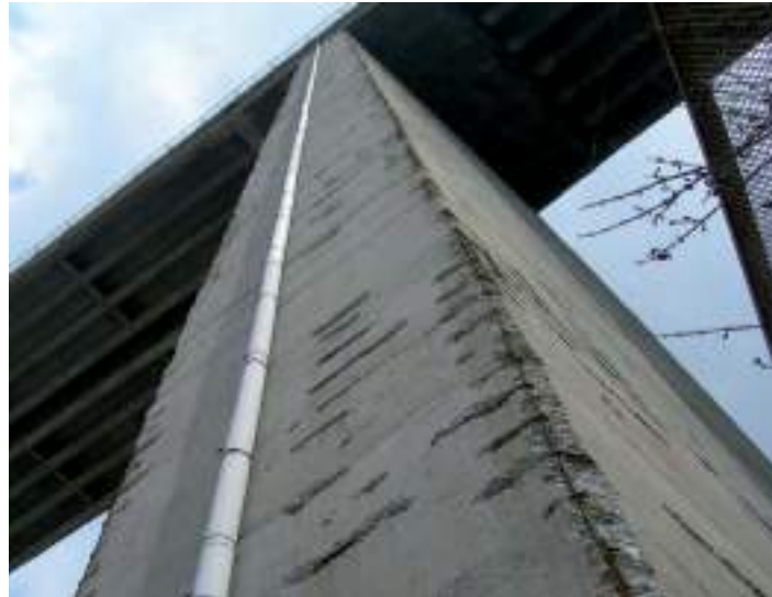
Рис. 3. Пример разрушения, вызванного внешней средой
