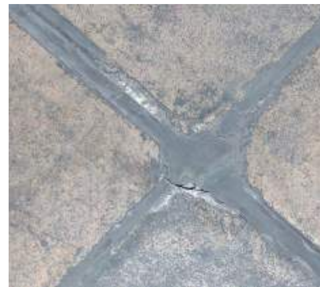
Рис. 19. Пример разрушения в стыках
