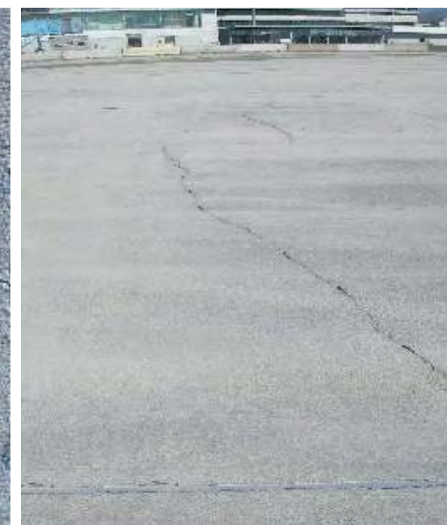
Рис. 17. Трещина в бетонной плите
