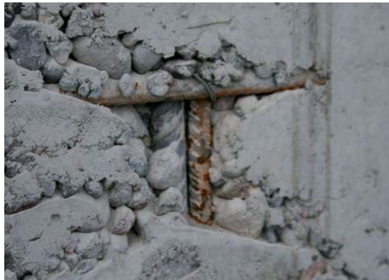
Рис. 22. Открытые арматурные стержни в бетоне
