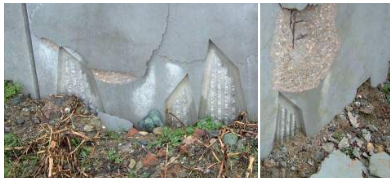
Рис. 14. Разрушение, вызванное циклами замораживания/оттаивания
